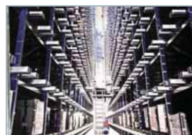
12 magazzino pallet automatico - automatic storing system
